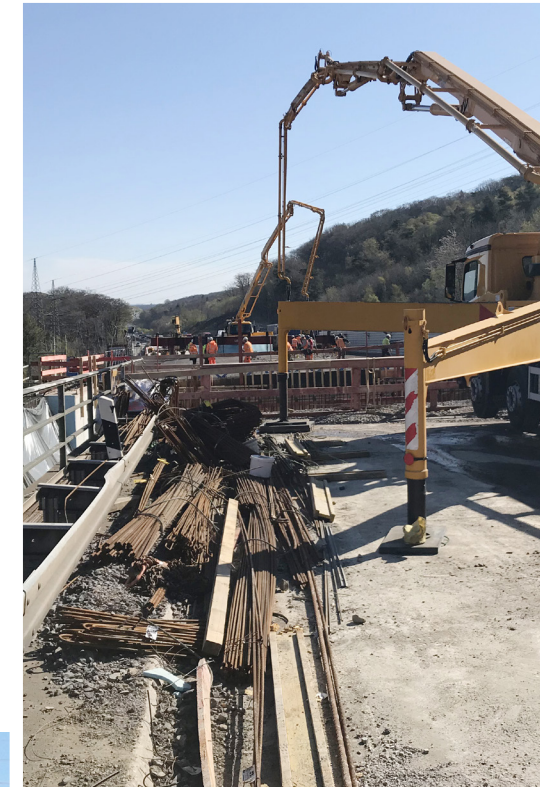
Mai 2021: Der Rohbau des zweiten Teilbauwerks wurde infolge Beschleunigungsmaßnahmen nach nur einem Jahr Bauzeit fertiggestellt
