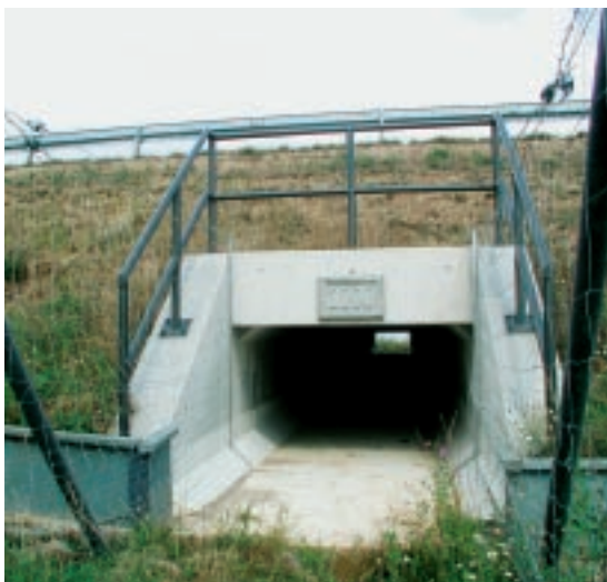
Kleintier- und Amphibiendurchlass.
